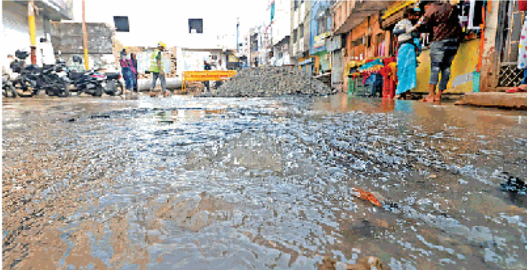
इंदौर : सुधारी गई पाइपलाइन से परीक्षण के लिए जैसे ही पानी सप्लाई किया गया, वह फूट गई। भागीरथपुरा मुख्य मार्ग पर जलमग्न सड़क • बईदुबिया
